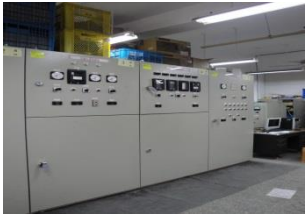
乙級工業配線 檢定場(一樓)
