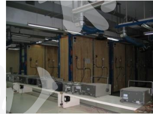
室內配線工場 (地下室)
